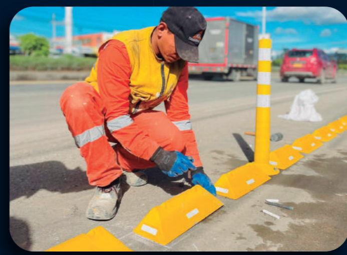
INSTALACIÓN DE BORDILLO TRANSPASABLE CL 80 Km 1 VÍA COTA CTO No.04 DE 2022 PROVELSCO SAS
